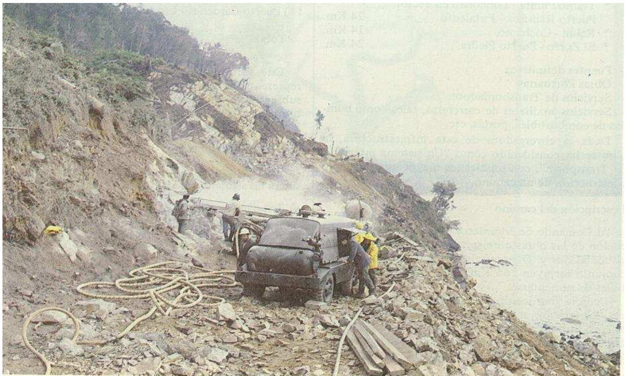
Trabajos de hombres y maquinarias en el agreste y difícil trazado, de la Carretera General Pinochet
